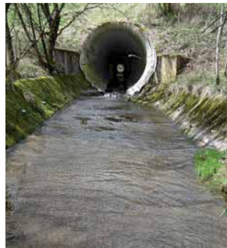
L'autoroute E25 coupe plusieurs cours d'eau en tête de bassin. Certains franchissements sont problématiques du fait de leur longueur, de l'effet «chasse d'eau» et de l'écoulement laminaire dans l'ouvrage.
